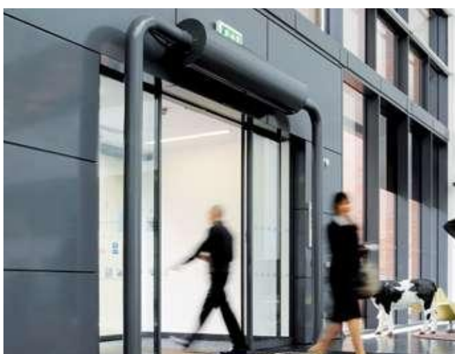
Rund Instalación con soportes especiales tipo portería
