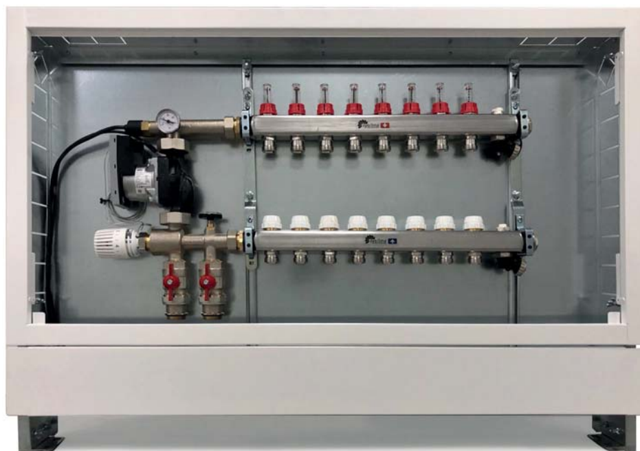
Grupo completo colector punto fijo con circulador DN 25. Caja blanca metálica empotrable H 1050. Colector Sysclima Inox 1" con Caudalímetro ICL 8 S.
